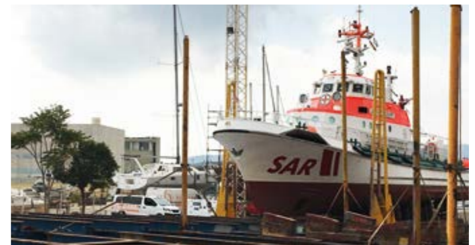
Auf einer Werft in der spanischen Hafenstadt Algeciras wird die Stevenrohrleckage der ALFRIED KRUPP repariert.
